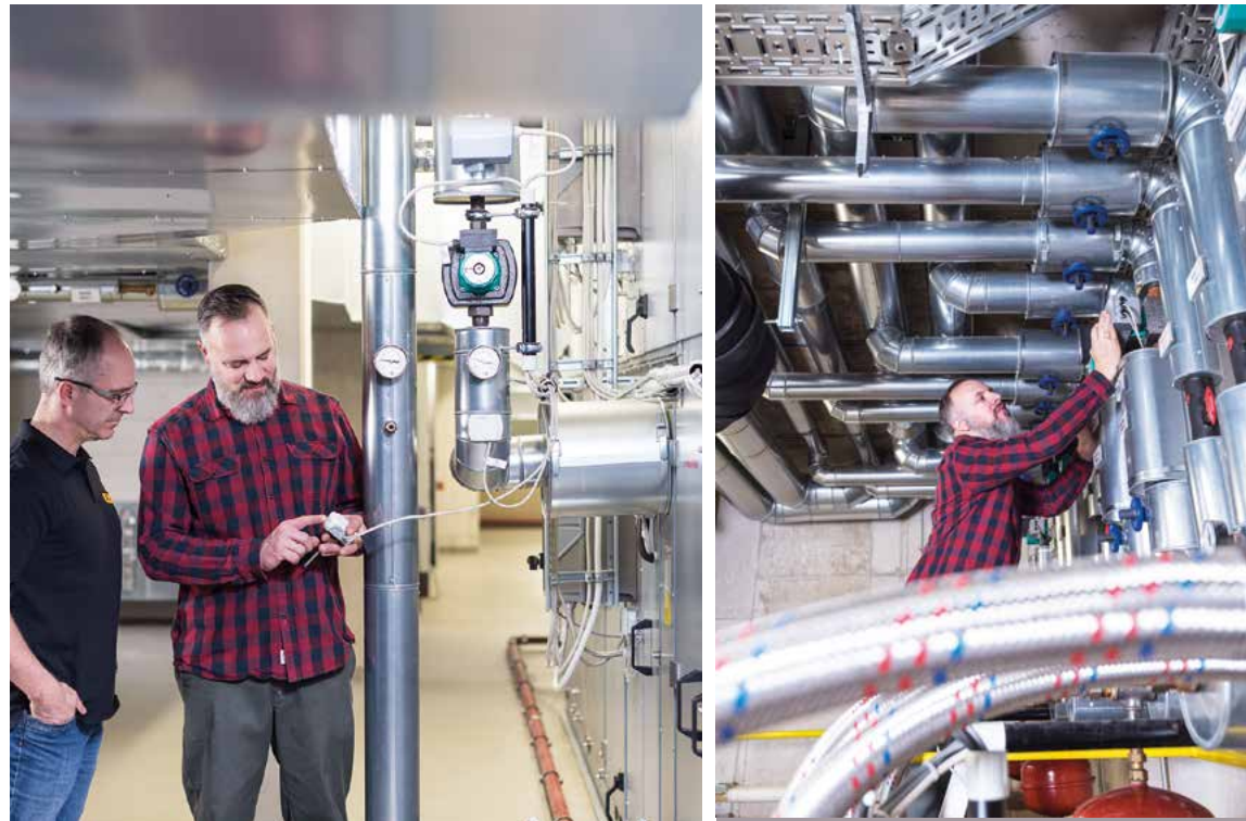
Kontrolle und Optimierung Anlagentechnik
