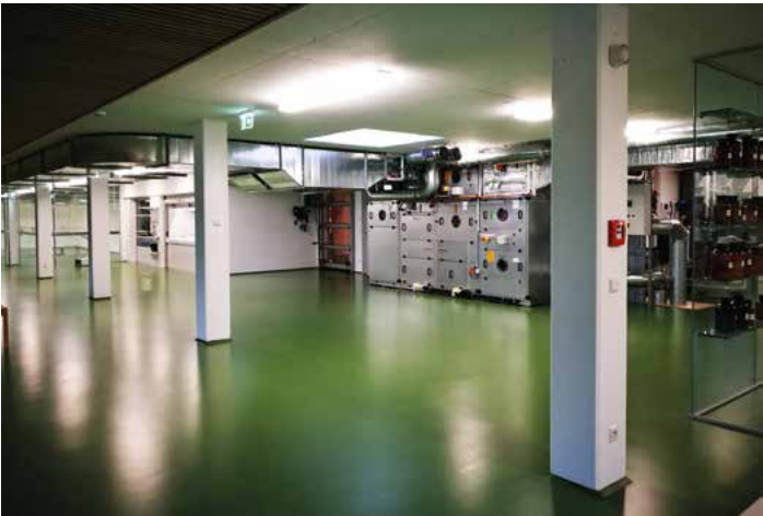
Heizraum und Digitale Ablese Haus Schnifis
